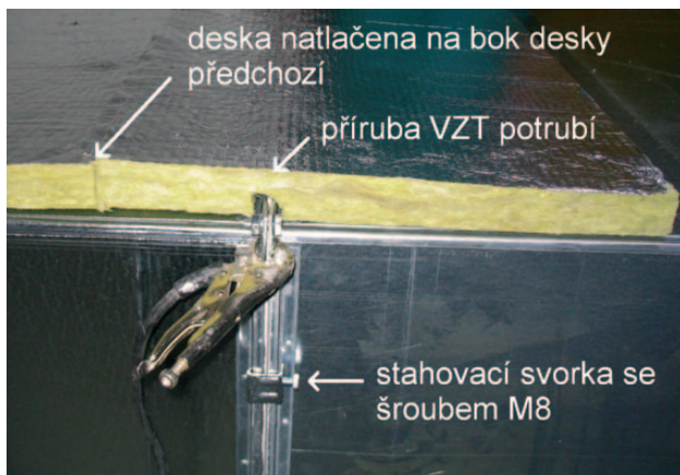
Obr. 26 Spojení izolačních desek leží mimo příruby VZT potrubí
