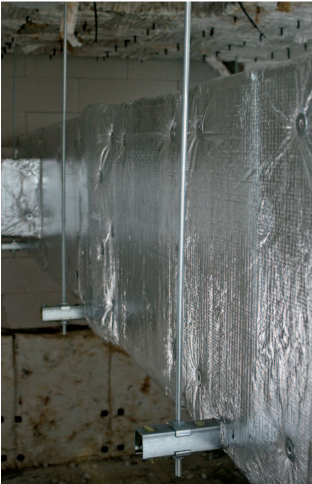
Obr. 21 Zавěšení potrubí závitovými tyčemi a instalačními profily. Na obrázku závitové tyče umístěny vně izolace (část instalačního profilu vyčnívajícího z izolace se v tomto případě neizoluje).
