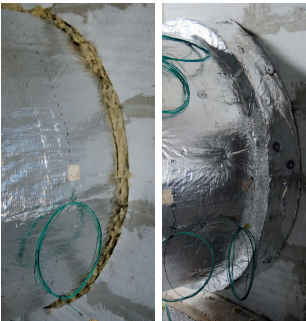
Obr. 36 Požární ucpávka řešená izolačním límcem - před provedením izolační manžety z druhé vrstvy lamelové rohože se nejdříve docpe mezíprostor mezi izolovaným potrubím a požárně dělicí konstrukcí
