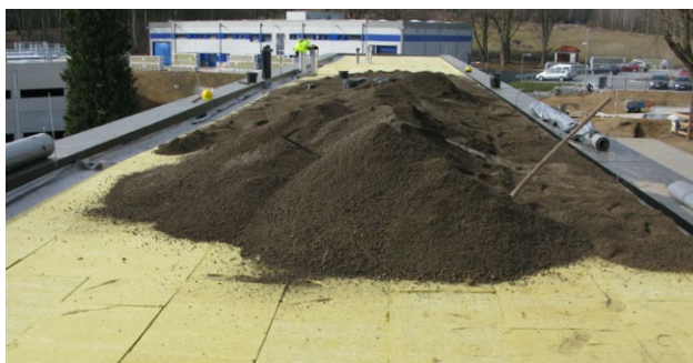
Rozprostření substrátu při realizaci, nutno počítat i s takovýmto dočasným lokálním přitížením, foto: ACRE
