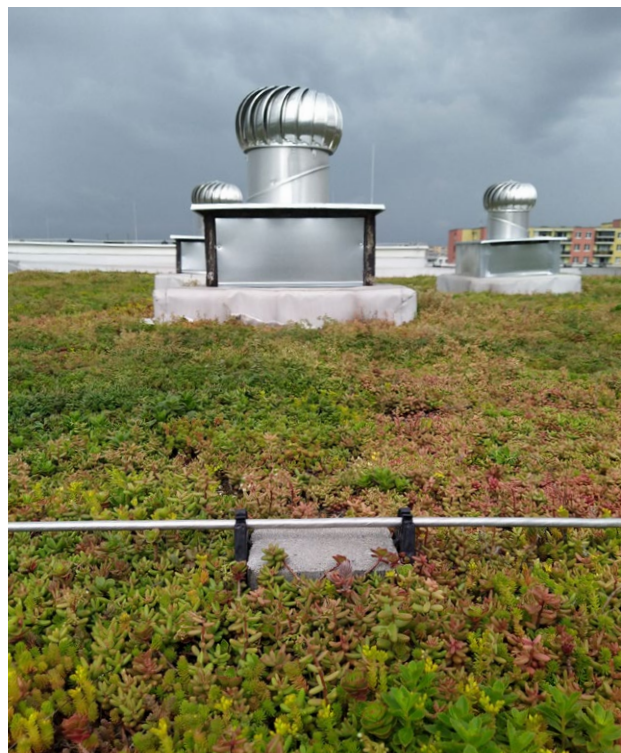
Kotvicí bod s ocelovým drátem propojující jímací soustavu
